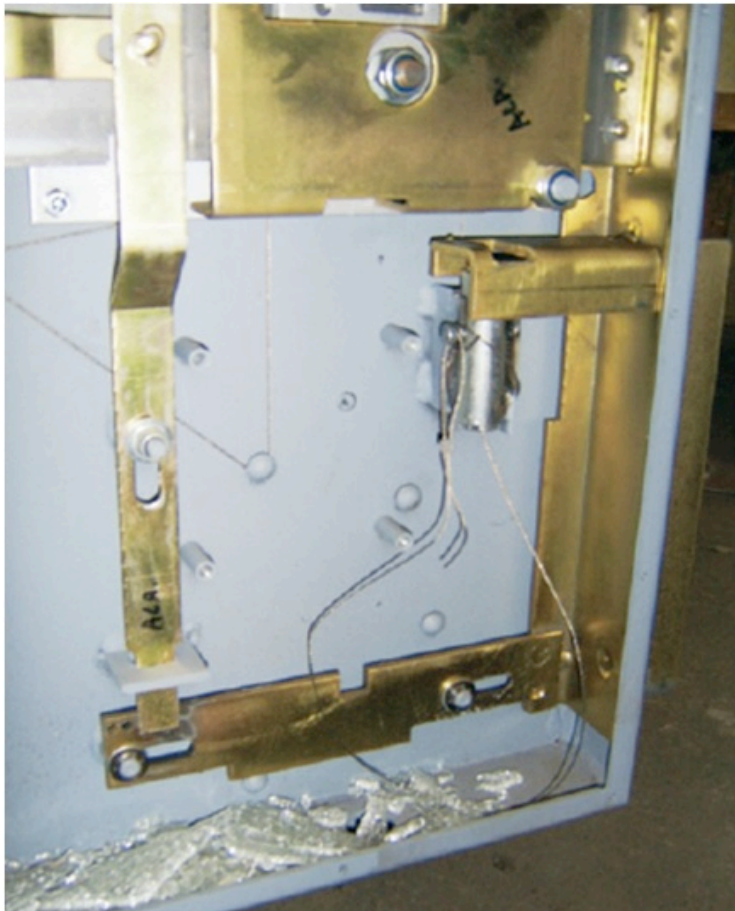
Fehlerhafte Umrüstung eines Wertschutzschrankes
